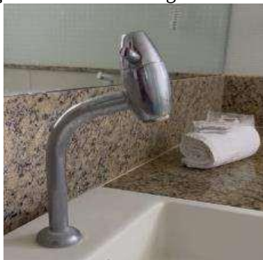
Controle de Desperdício com válvula reguladora de água
