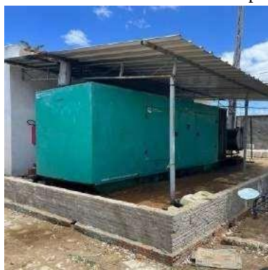
Figura 11 – Uso de Gerador em Meio de Hospedagem de Mossoró
