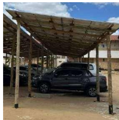
Estrutura da usina solar como estacionamento
