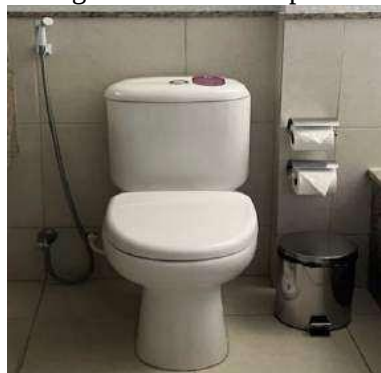
Equipamentos com controle de vasão d'água
