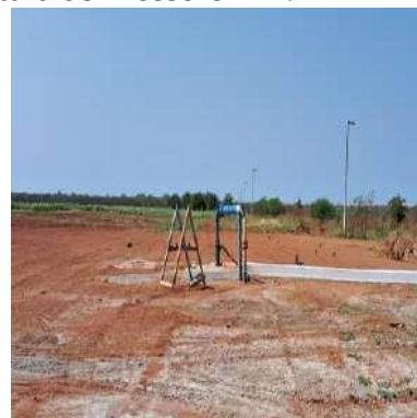
c. Poço Profundo
